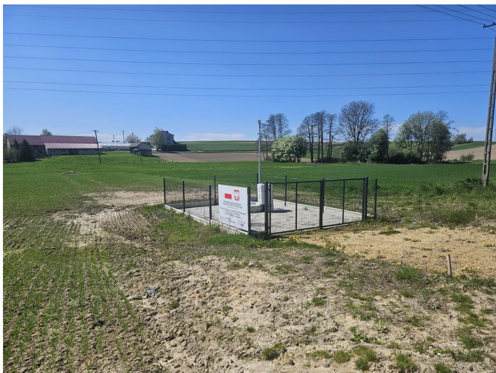
fot. archiwum Urzędu Gminy – przepompownia ścieków
